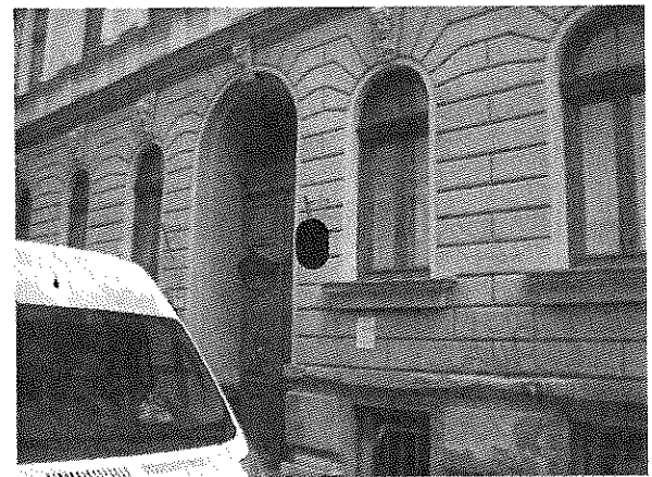
épület utcafronti bejárata, házszám, vizesedés nyoma az utcafronti homlokzaton
