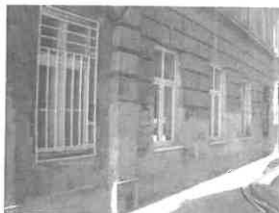
vakolatleválás, vízesedés nyoma az utcáfronti homlokzaton
