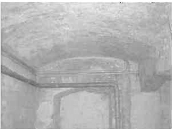
társasházi közműhálózat vezetéke
