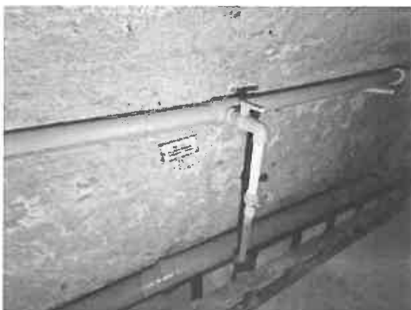
társasházi közműhálózat vezetéke
