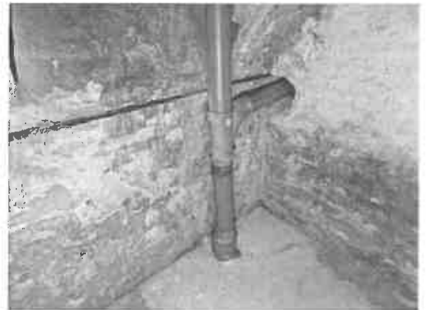
társasházi közműhálózat vezetéke
