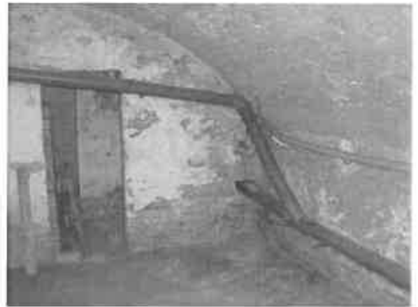
társasházi közműhálózat vezetéke
