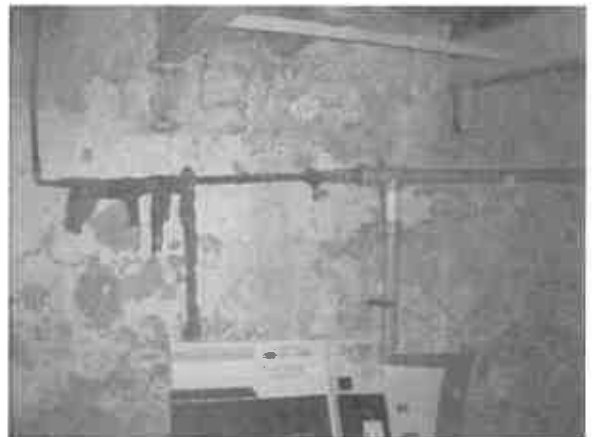
társasházi közműhálózat vezetéke
