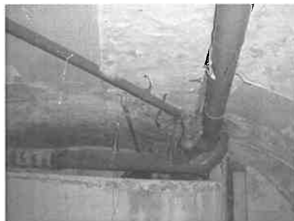
társasházi közműhálózat vezetékei
