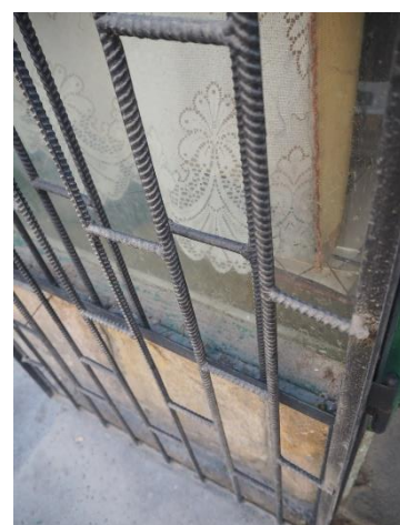
17. ráccsal védett nyílászáró
