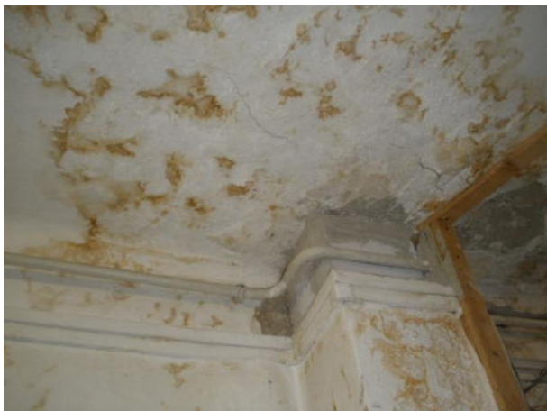
beázás nyoma a közlekedőben
