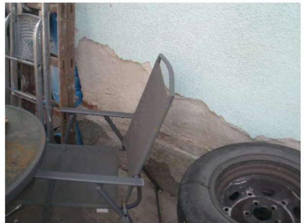
vakolatleválás a homlokzaton
