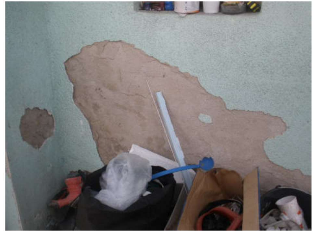
vakolatleválás a homlokzaton
