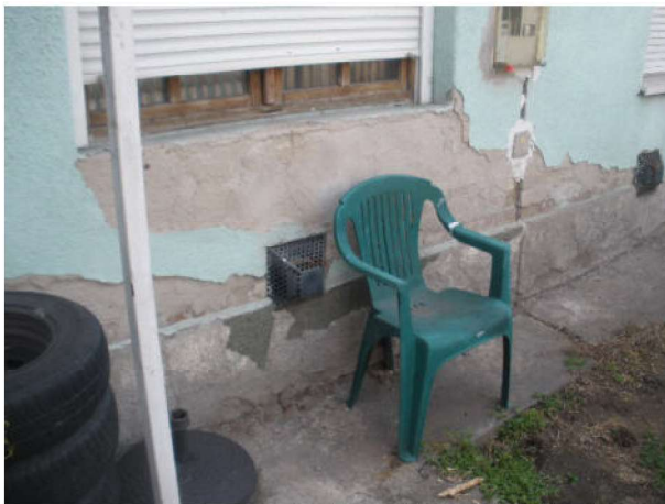
vakolatleválás a homlokzaton
