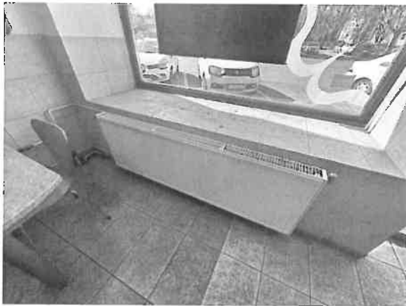
Nyílászáró, hőleadó radiátor
