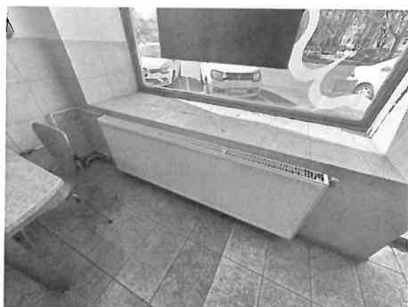
Nyílászáró, hőleadó radiátor
