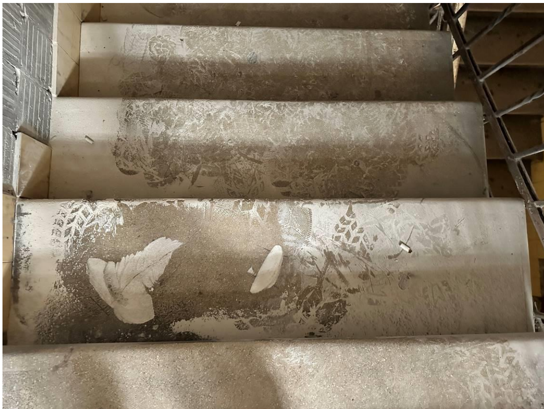
a. jelű kép: I. emeletre vezető lépcsőkar 8. lépcsőfoka – 1
