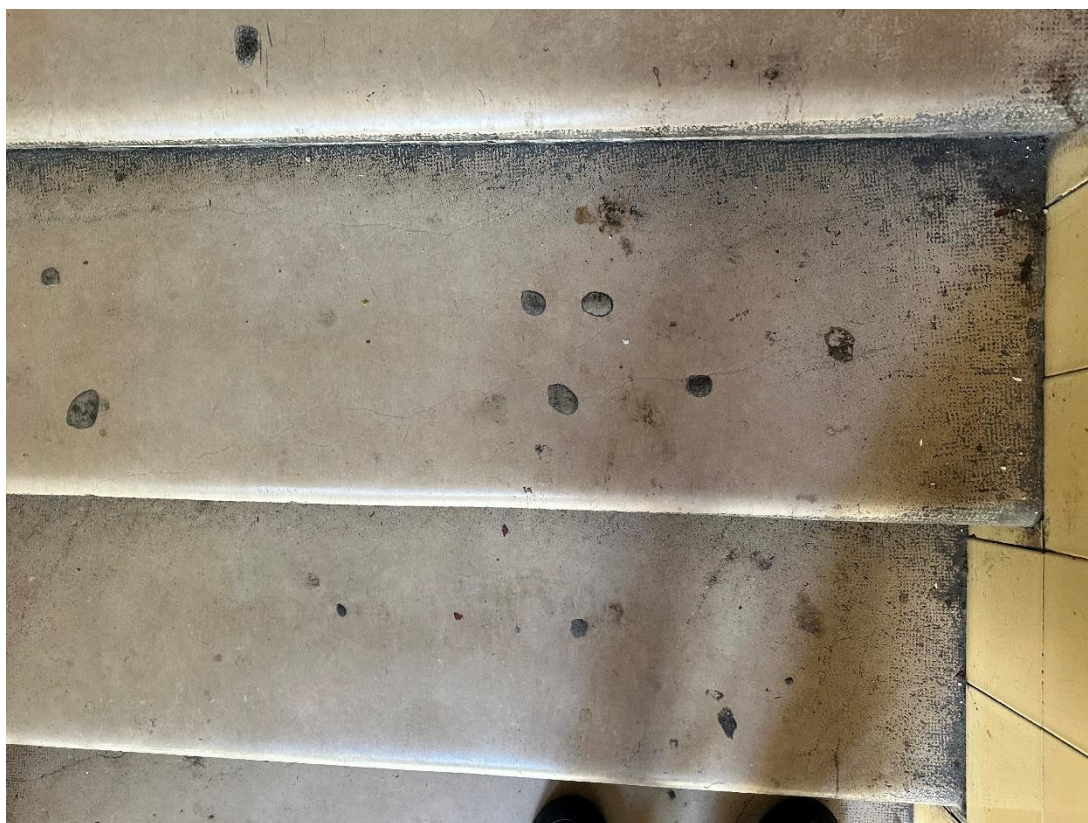
72. számú kép: 3. emelet pihenőszintjére vezető lépcsőkar 11. és 12. lépcsőfoka – hossz- és keresztirányú repedések
