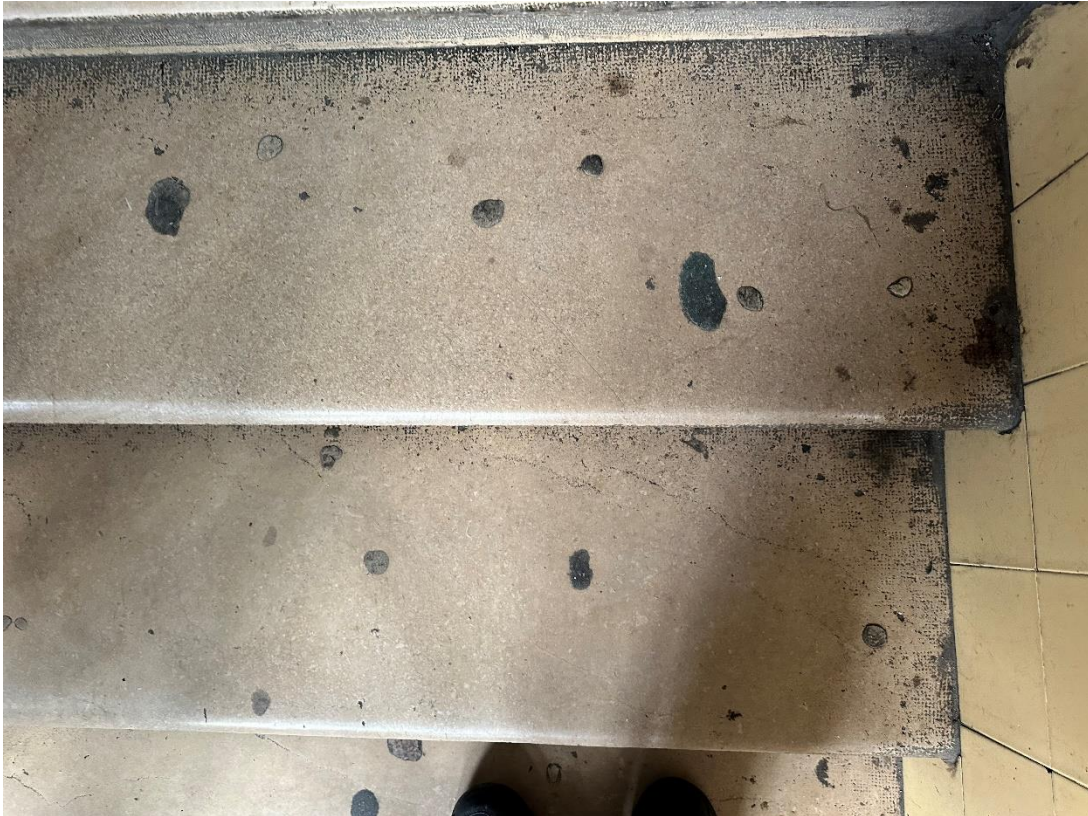
61. számú kép: 2. emelet pihenőszintjére vezető lépcsőkar 3. és 4. lépcsőfoka – hossz- és keresztirányú repedések
