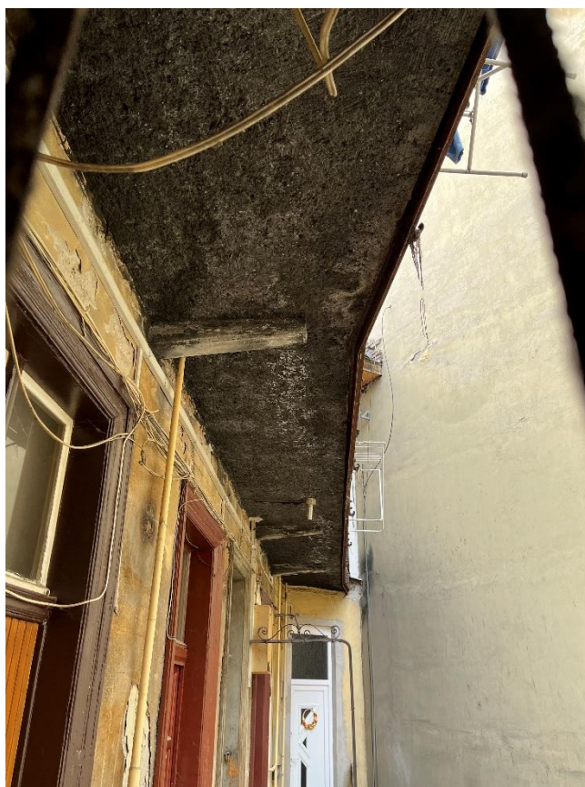
30. számú kép: 3. emeleti függőfolyosó – alulról nézve – 6
