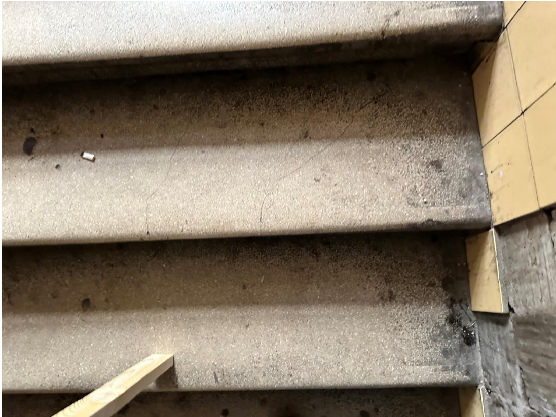
59. számú kép: 1. emeletre vezető lépcsőkar 7. és 8. lépcsőfoka – keresztirányú repedések
