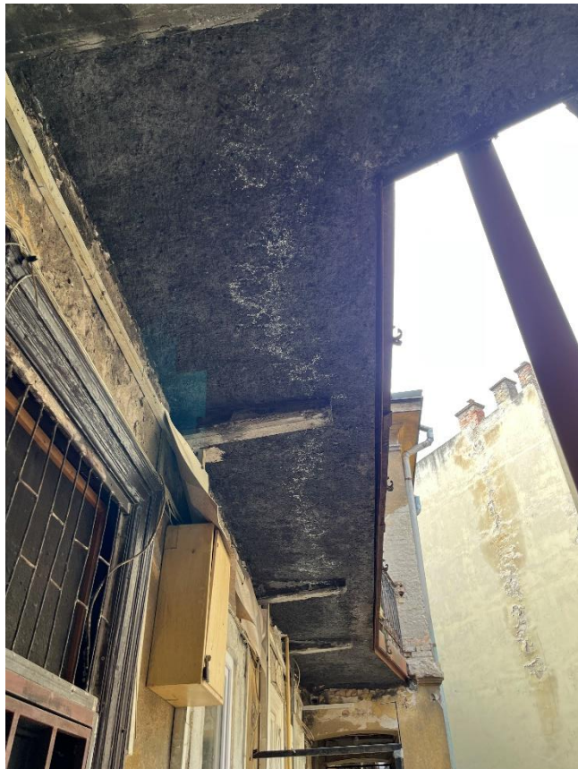
28. számú kép: 3. emeleti függőfolyosó – alulról nézve – 4
