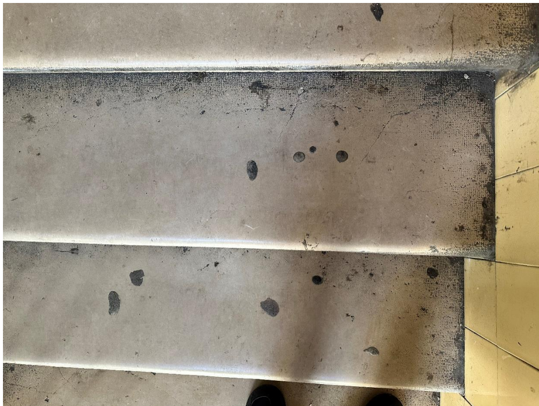
71. számú kép: 3. emelet pihenőszintjére vezető lépcsőkar 9. és 10. lépcsőfoka – hossz- és keresztirányú repedések
