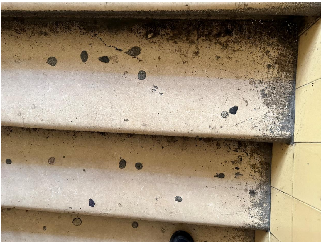
75. számú kép: 3. emeletre vezető lépcsőkar 5. és 6. lépcsőfoka – hosszirányú repedések
