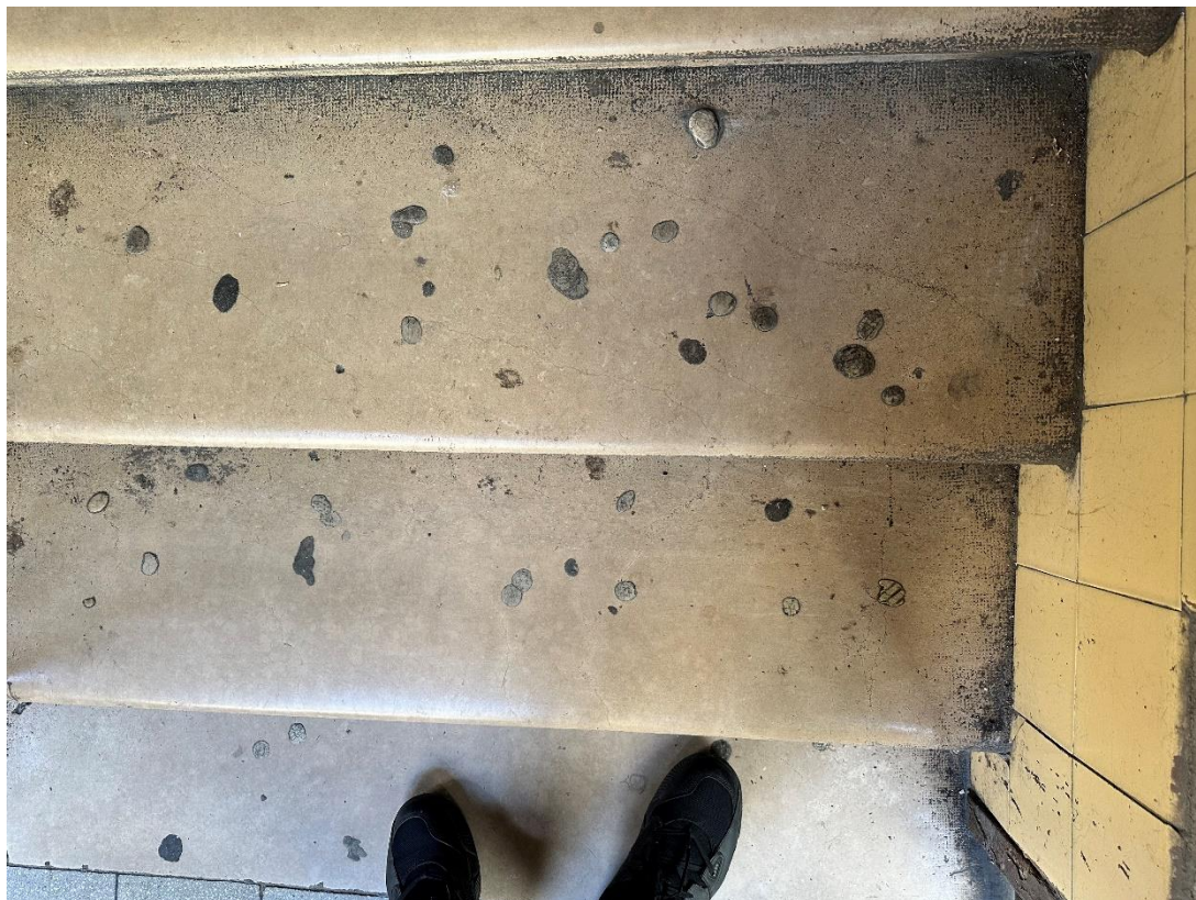
67. számú kép: 3. emelet pihenőszintjére vezető lépcsőkar 1. és 2. lépcsőfoka – hossz- és keresztirányú repedések
