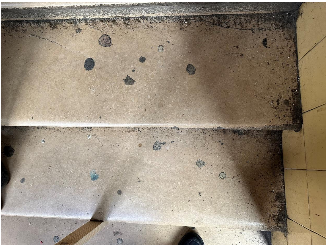
60. számú kép: 2. emelet pihenőszintjére vezető lépcsőkar 1. és 2. lépcsőfoka – hosszirányú repedések
