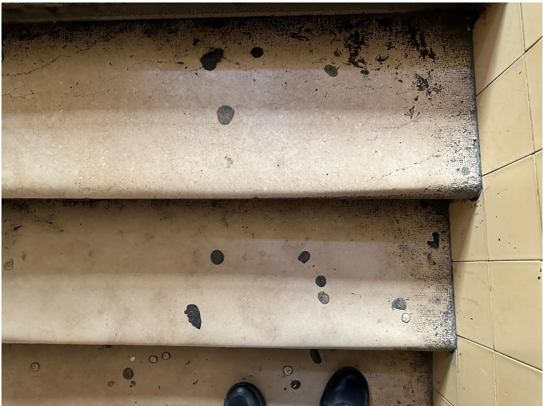
64. számú kép: 2. emeletre vezető lépcsőkar 1. és 2. lépcsőfoka – hosszirányú repedések
