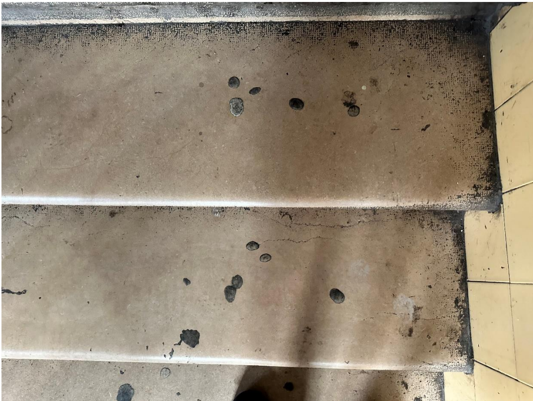
62. számú kép: 2. emelet pihenőszintjére vezető lépcsőkar 5. és 6. lépcsőfoka – hosszirányú repedések
