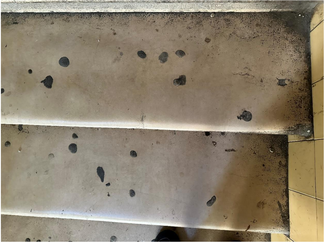
63. számú kép: 2. emelet pihenőszintjére vezető lépcsőkar 11. és 12. lépcsőfoka – hosszirányú repedések
