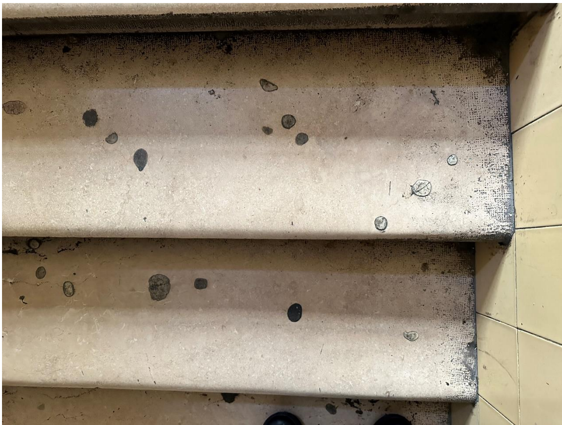
65. számú kép: 2. emeletre vezető lépcsőkar 3. és 4. lépcsőfoka – hosszirányú repedések
