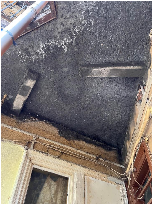
15. számú kép: 2. emeleti függőfolyosó – alulról nézve – 4
