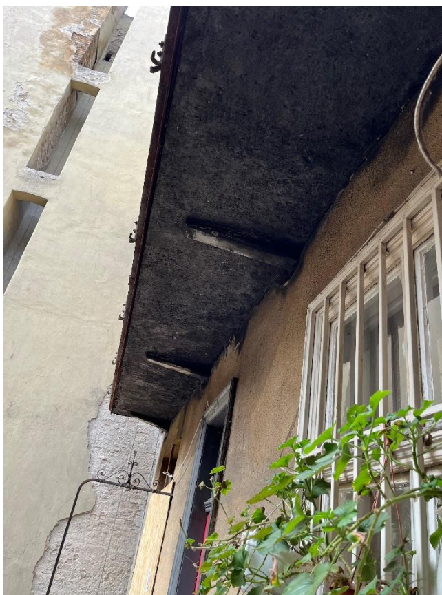
16. számú kép: 2. emeleti függőfolyosó – alulról nézve – 5
