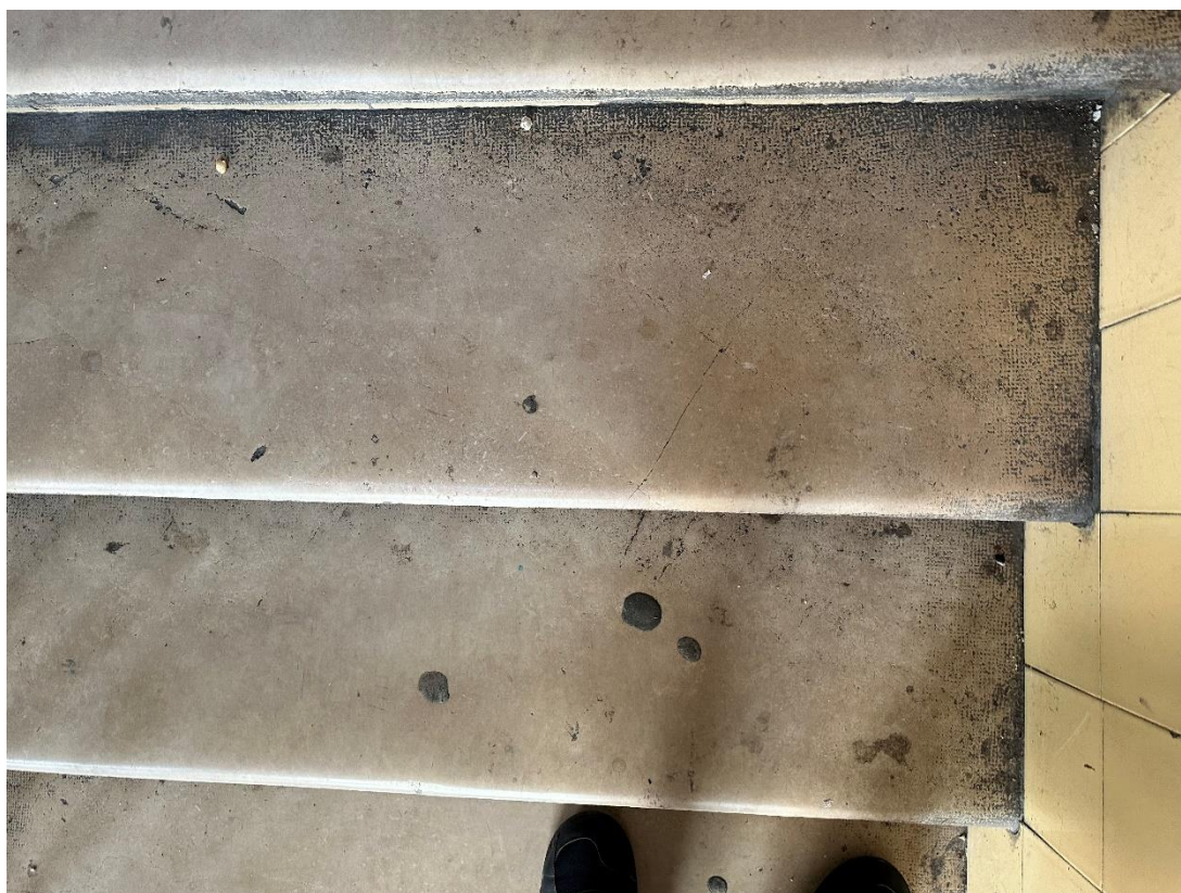
70. számú kép: 3. emelet pihenőszintjére vezető lépcsőkar 7. és 8. lépcsőfoka – keresztirányú repedések
