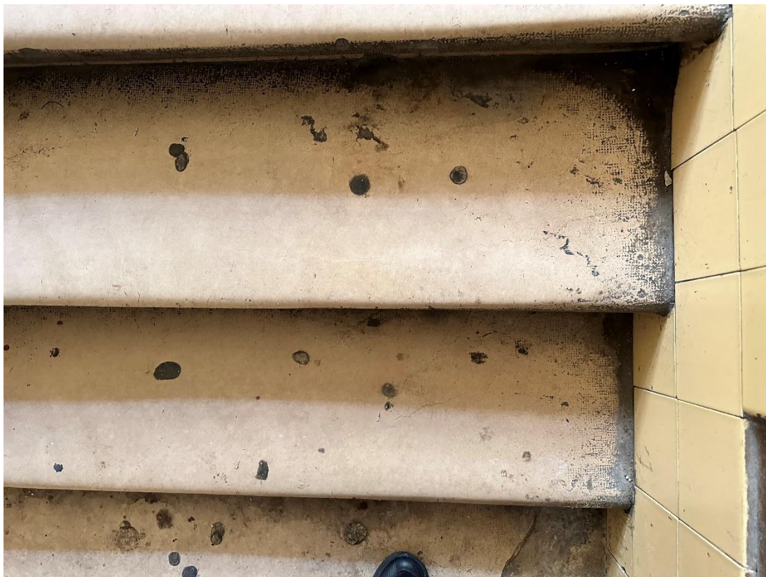
73. számú kép: 3. emeletre vezető lépcsőkar 1. és 2. lépcsőfoka – hossz- és keresztirányú repedések
