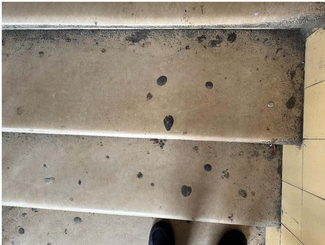
69. számú kép: 3. emelet pihenőszintjére vezető lépcsőkar 5. és 6. lépcsőfoka – hossz- és keresztirányú repedések
