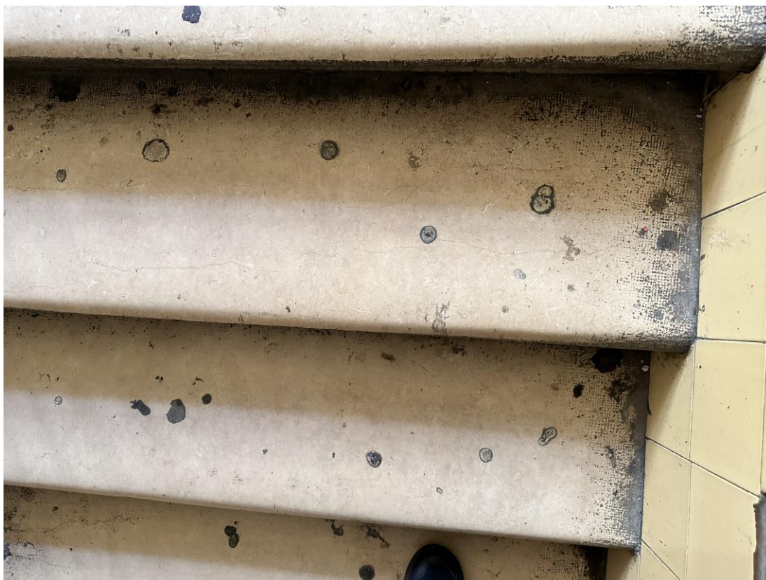
74. számú kép: 3. emeletre vezető lépcsőkar 3. és 4. lépcsőfoka – hosszirányú repedések
