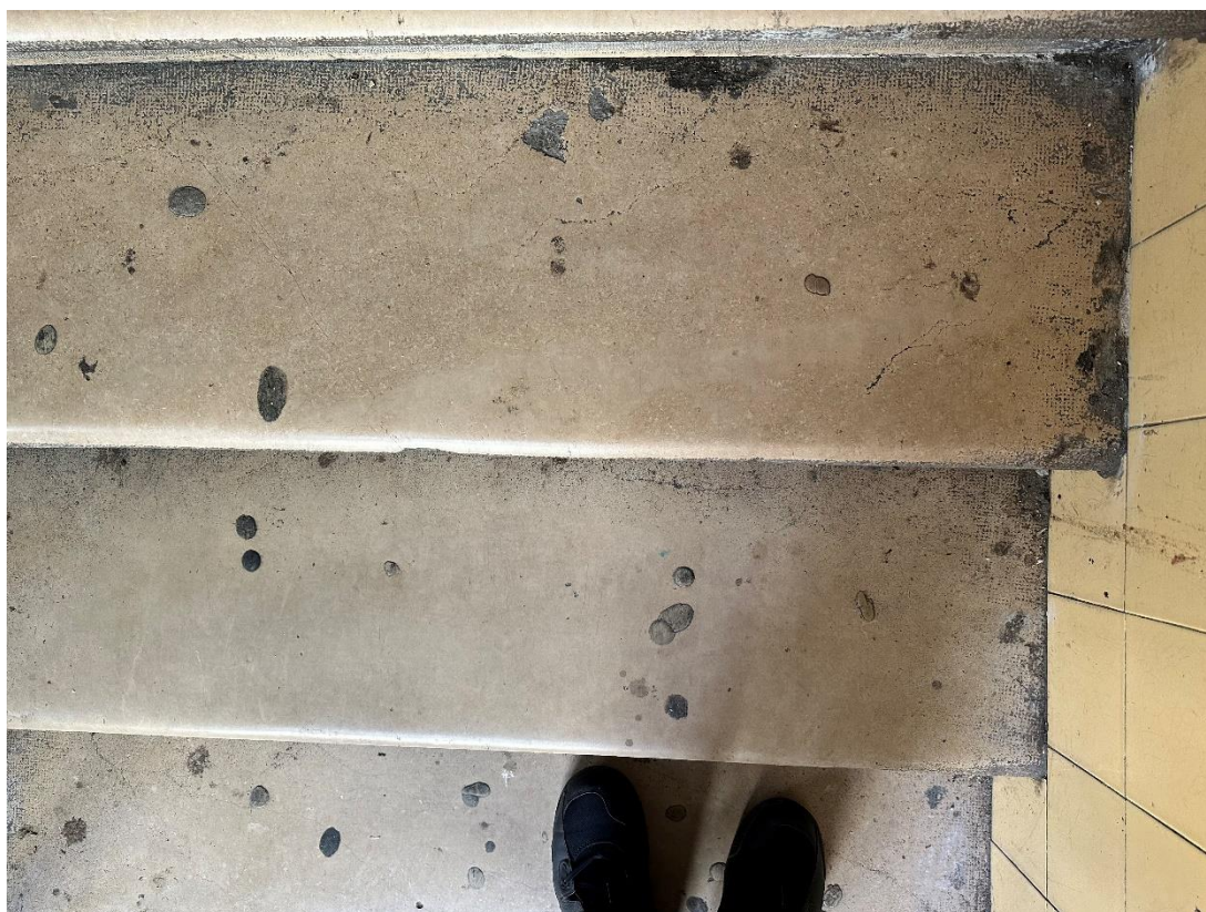
68. számú kép: 3. emelet pihenőszintjére vezető lépcsőkar 3. és 4. lépcsőfoka – keresztirányú repedések
