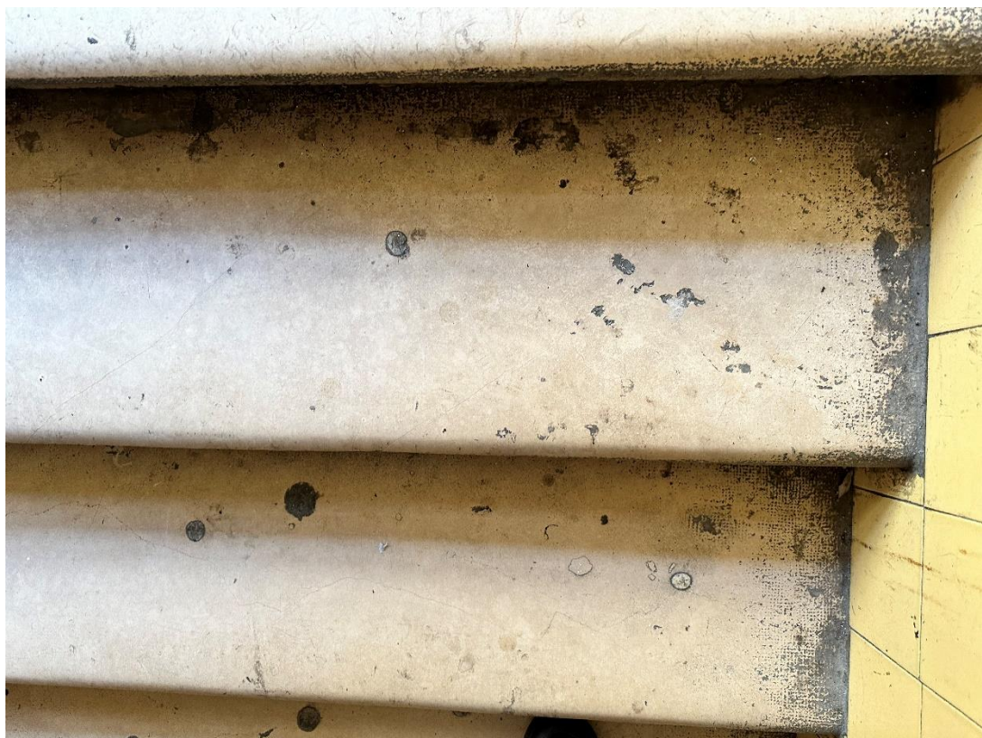
77. számú kép: 3. emeletre vezető lépcsőkar 9. és 10. lépcsőfoka – hossz- és keresztirányú repedések
