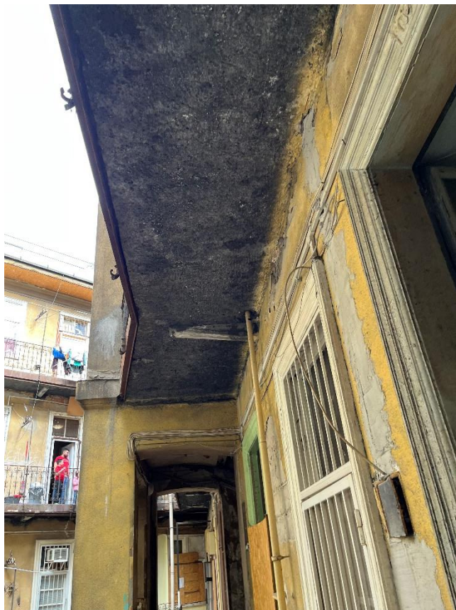
13. számú kép: 2. emeleti függőfolyosó – alulról nézve – 2
