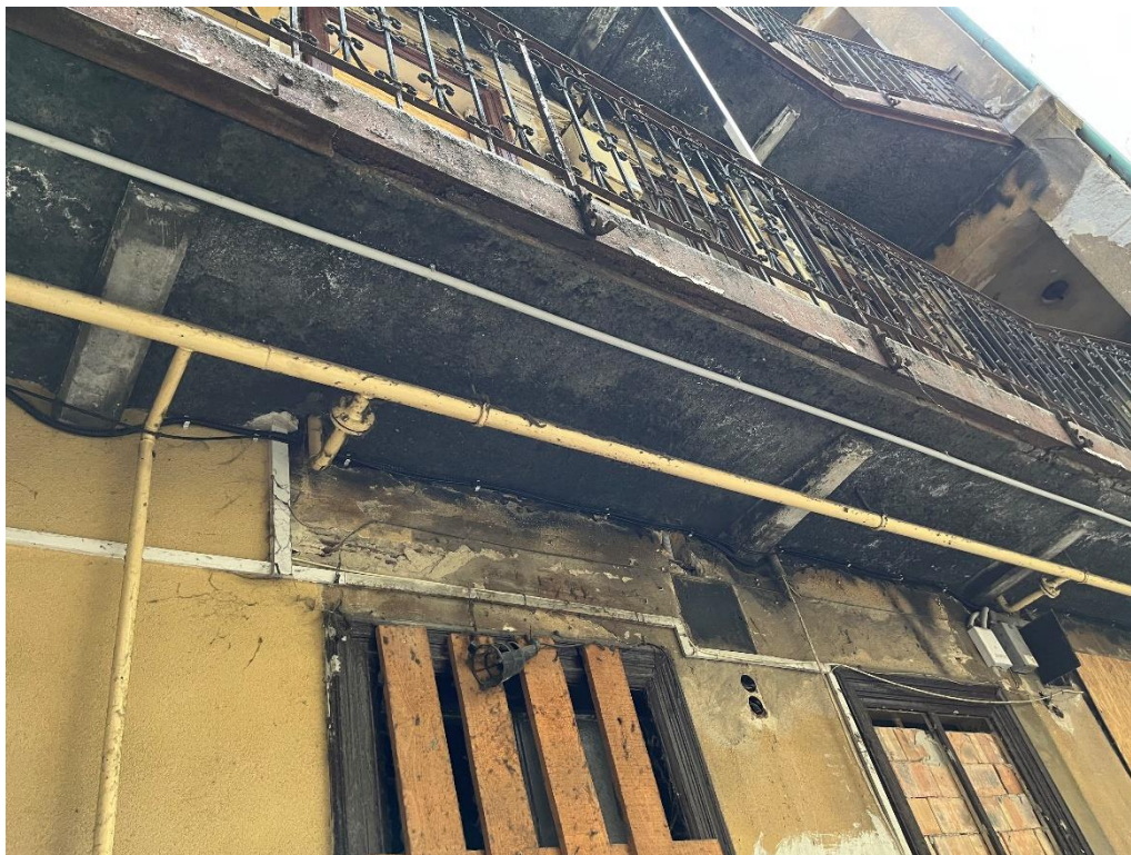
3. számú kép: 1. emeleti függőfolyosó – alulról nézve - 3
