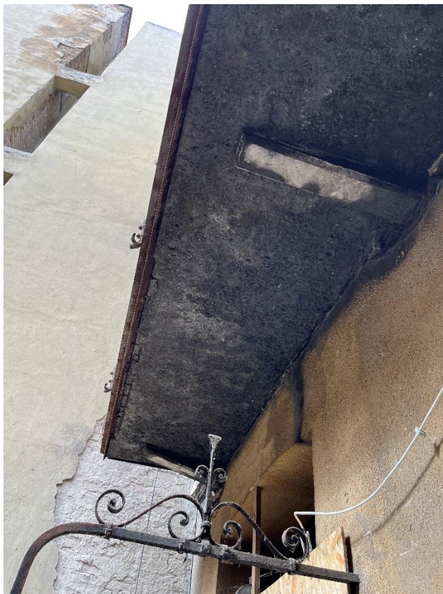
17. számú kép: 2. emeleti függőfolyosó – alulról nézve – 6
