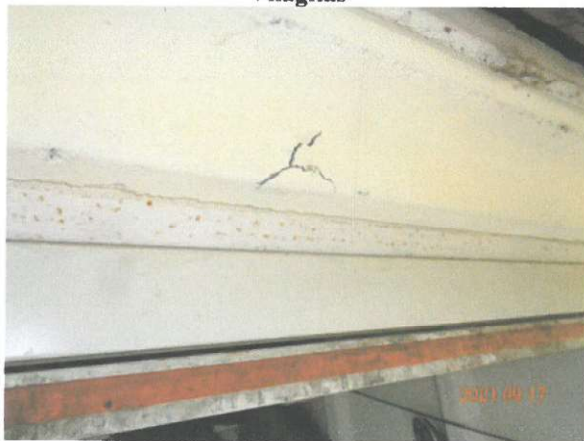
Leázás miatti hajszálrepedések
