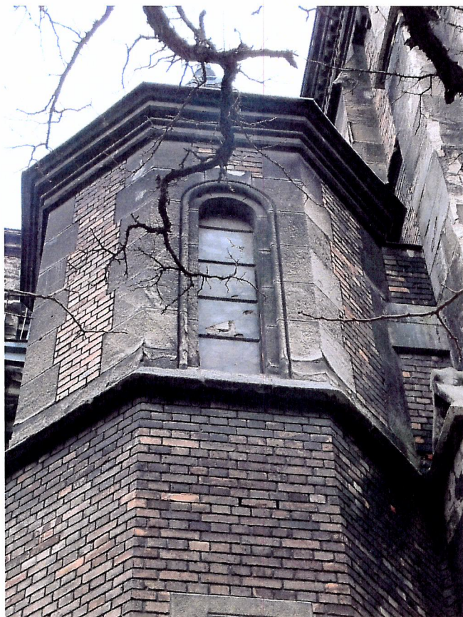
Lépcsőtorny tört ablaküvegei északról
