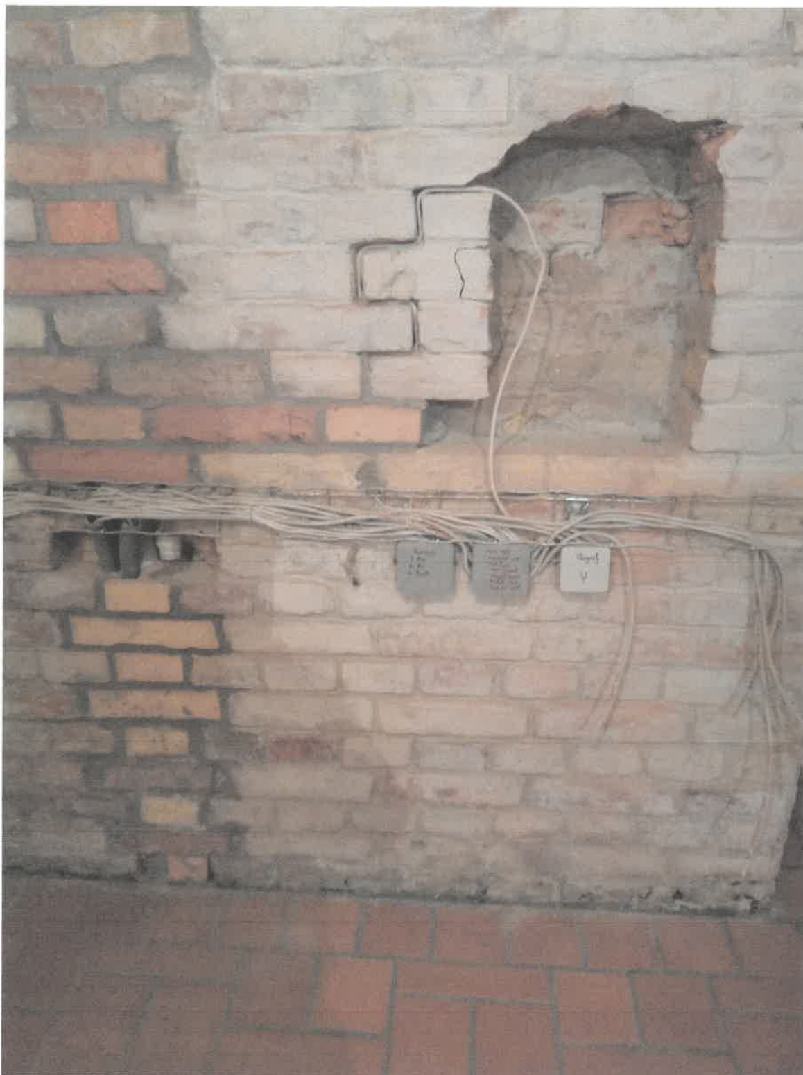
Kábeltartó konzolok és az elektromos vezetékek
