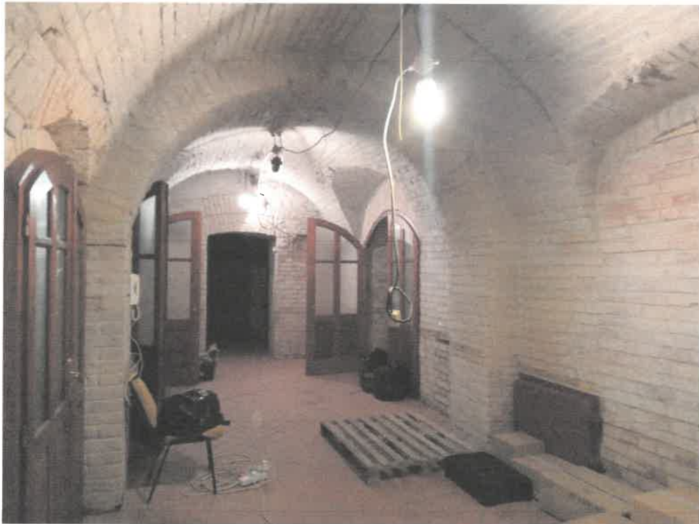
Ideiglenes kábelek, megépült új alapvezeték hálózat
